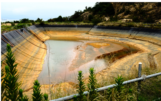
雨水などを管理するためのトレンチで有害物質の流出を防いでいる
